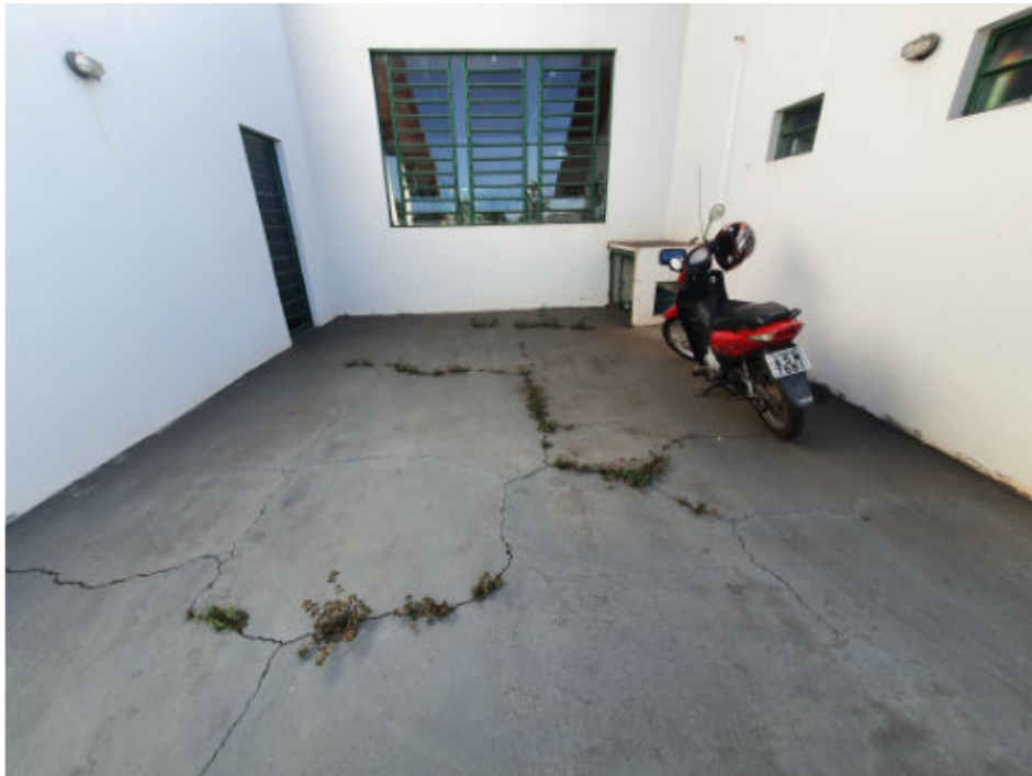
Imagem 3 – Foto do piso. Promover a remoção dos matos e das rachaduras.
